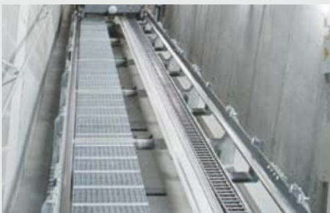
Schacht mit Steg für Wartungsarbeiten
