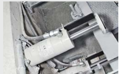
Die Sicherheitspuffer in der Schachtgrube
